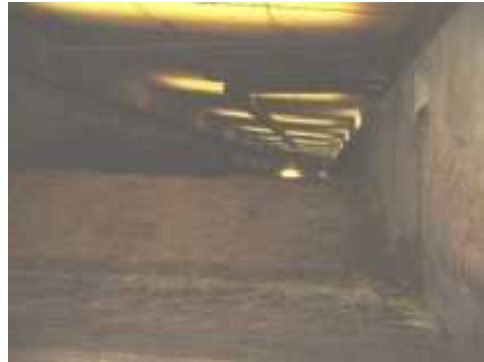
↑ 発酵・分解過程（バドル式高速発酵槽出口より）
