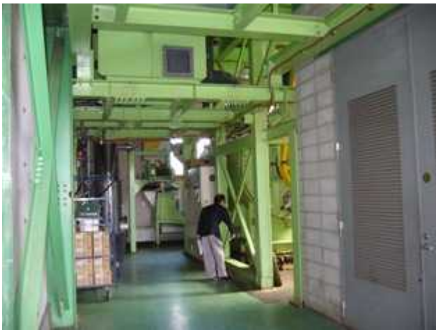
メイン装置 100度で加熱殺菌 減圧処理で効率的に乾燥させる
